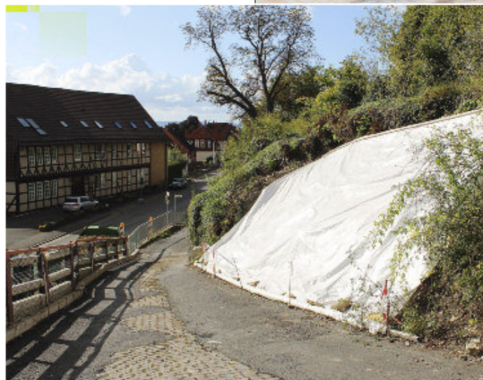
Die Zuwegung zur Burgschänke wird jetzt ausgeschrieben. Mit dem Abschluss der Baumaßnahme ist im Juli 2018 zu rechnen. Fotos (2): Sürle
